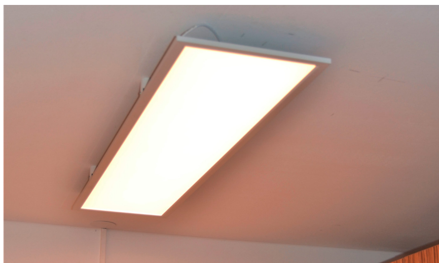
Modernes Beleuchtungskonzept unter Einsatz effizienter LED-Technik
