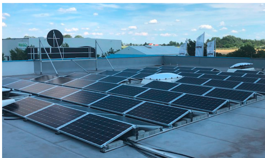
Die neu installierte Photovoltaikanlage senkt die jährlichen Strom- und Heizkosten deutlich.
