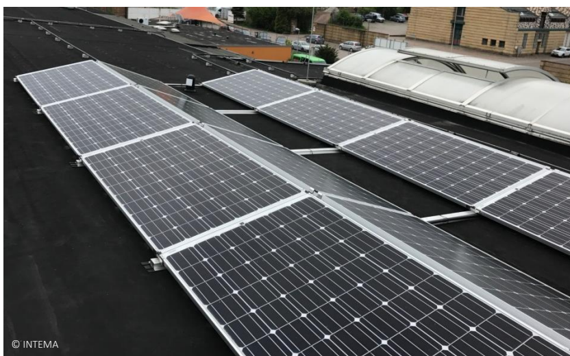
33,5 kW-Photovoltaikanlage auf dem energetisch sanierten Dach der INTEMA.
