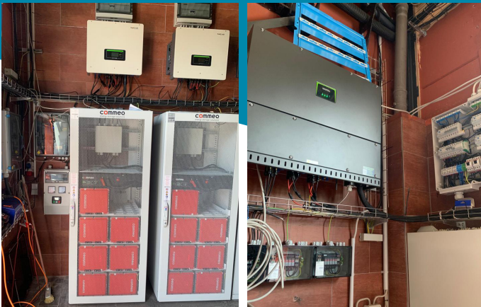
Die Steuerungstechnik der neuen Photovoltaikanlage.
