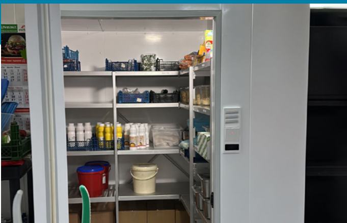
Neue Kühlräume lassen die Kälte drinnen und die Wärme draußen.
