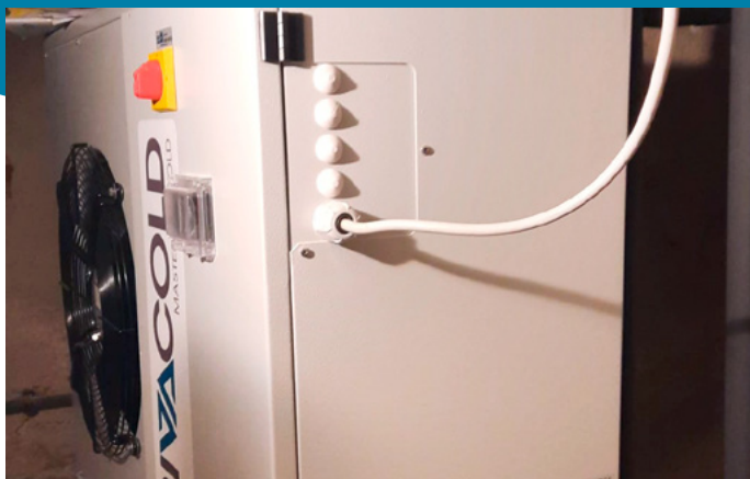
Externes Kühlaggregat mit Wärmerückgewinnung zur Raumbeheizung
