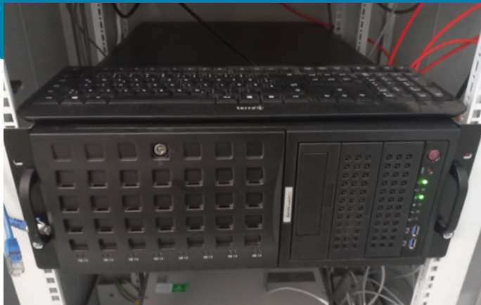
Neue Servertechnik senkt den Energieverbrauch.
