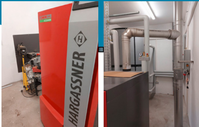
Eine neue effiziente Heizung wurde installiert.
