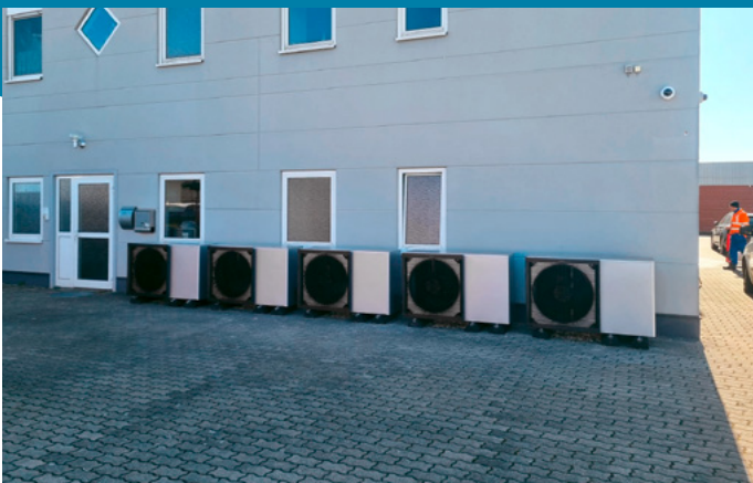
Eine neue Wärmepumpenanlage spart 41 MWh Gas pro Jahr.
