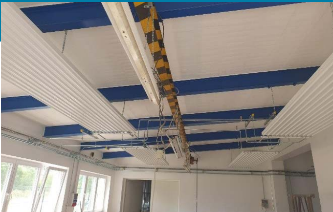
Neue Flächenstrahlungsheizkörper im Werkstattbereich des Unternehmens.
