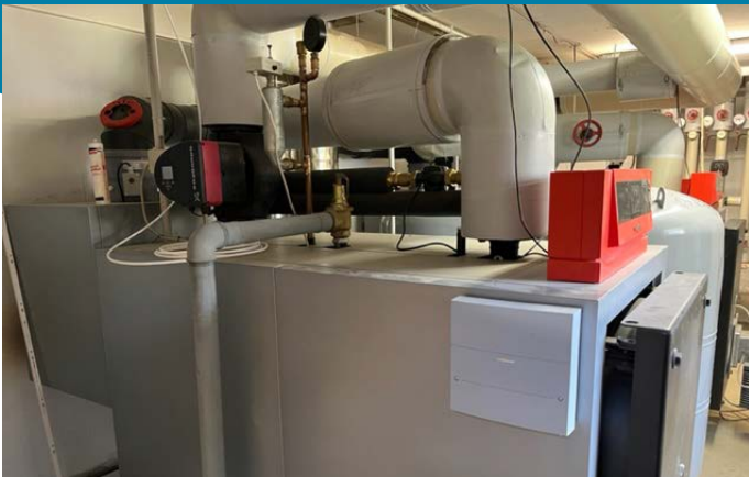
Modulierende Brennwerttherme zur effizienten Wärmeerzeugung und -versorgung im Ferienpark Harz.
