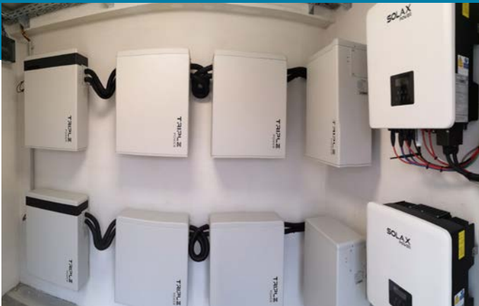
Wechselrichter und Speichermodule für die PV-Anlage.
