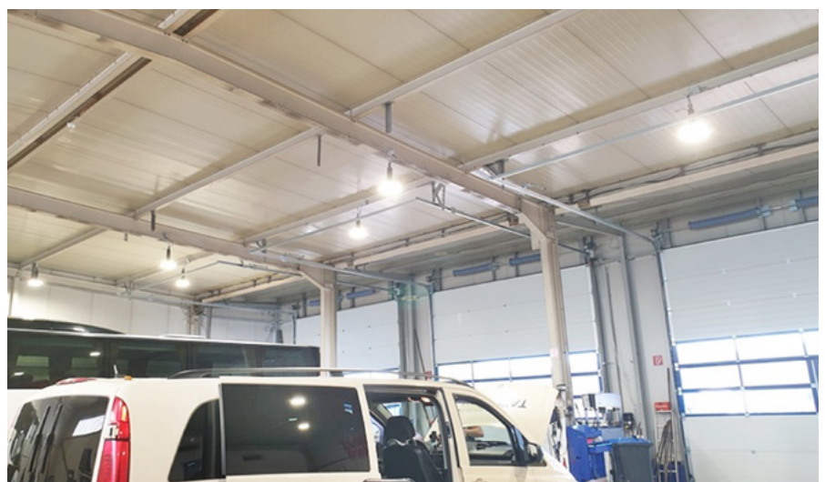
Neue energieeffiziente LED-Hallenbeleuchtung
