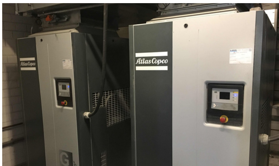
Neue drehzahlgeregelte Kompressoren mit von 36 auf 16 kW reduzierter Leerlaufleistung.
