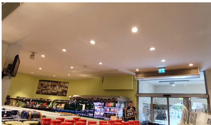
Die neue hocheffiziente LED-Beleuchtung setzt punktuelle Akzente.
