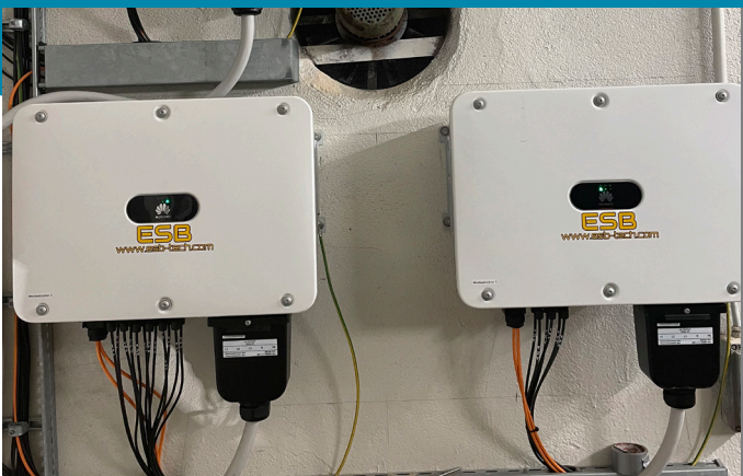
Wechselrichter an der neuen 100 kWp PV-Anlage.
