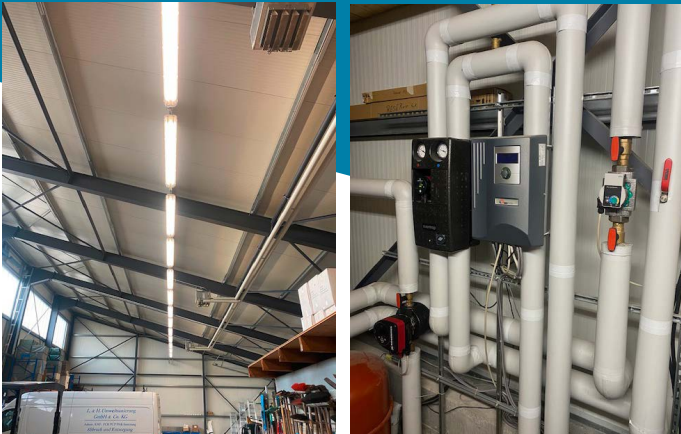
Neue Beleuchtung und neue Heizungspumpen sparen Energie.
