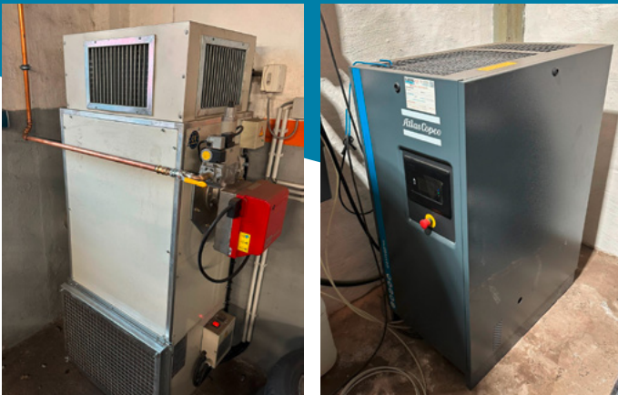
Eine neue Heizungsanlage (links) und ein frequenz geregelter Kompressor (rechts) arbeiten hocheffizient.
