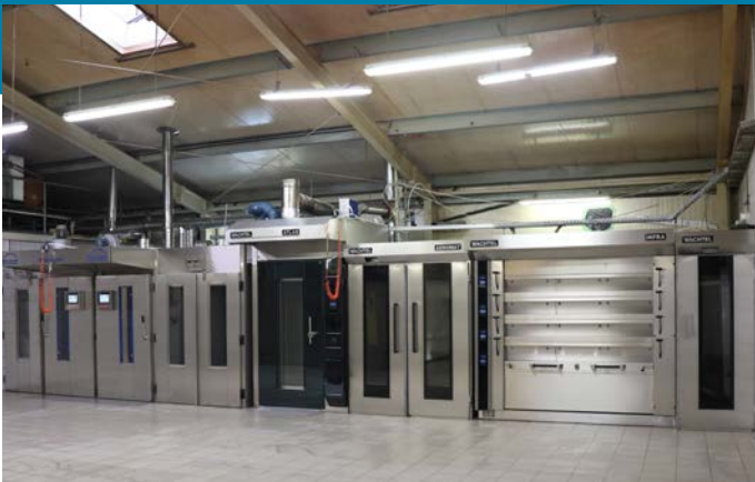
Ofen- und Gäräumenanlage mit besserer Dämmung auf dem neuesten Stand der Technik.
