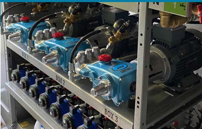
Hocheffiziente Wasseraufbereitungspumpen für die Selbstbedienungs-Waschboxen.
